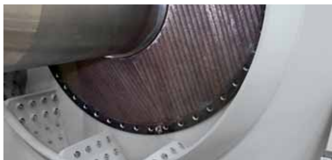
Защитное покрытие фланцевого соединения
